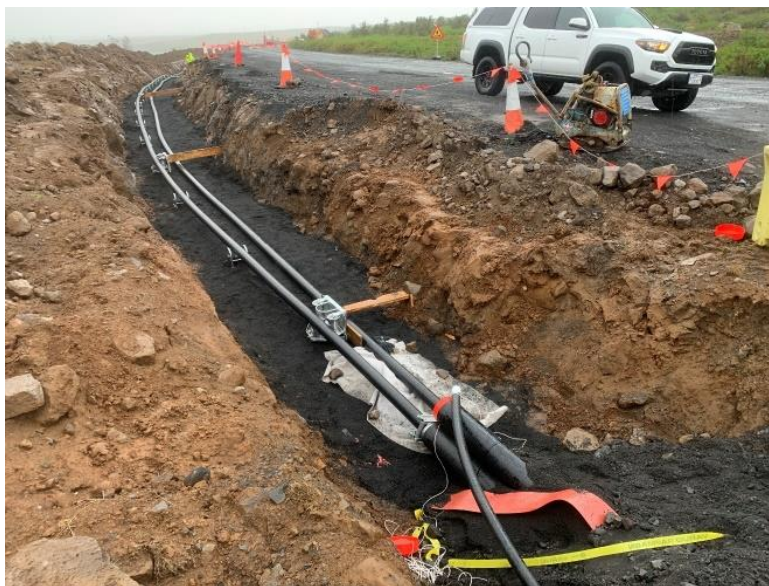
Mynd 3.15 Lögn Korpulínustrengs (132 kV) meðfram vegi.
