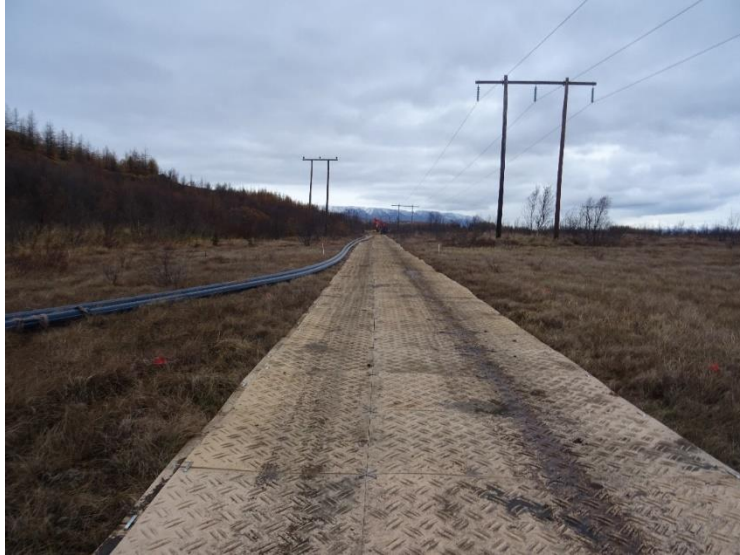
Mynd 3.5 Tvöfalt lag akstursplatna lag á blautt land sem vinnuslóð. Frá lagningu Hólasandslínu 3. Mynd: Landsnet.
